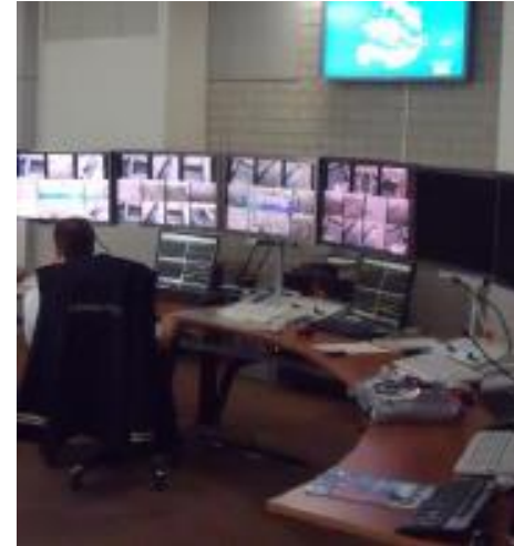
The bridge control centre for Rijkswaterstaat, Holland
